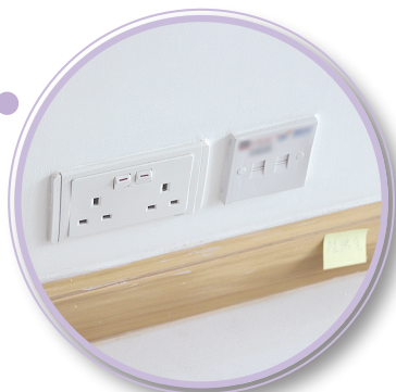
燈位和電力插頭的供電狀況
